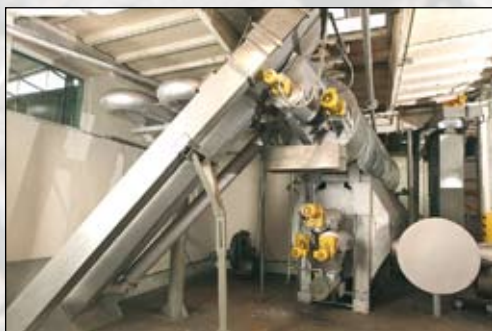
Linia technologiczna Termolizacyjnego Modułu Odzysku Energii. Reaktor
