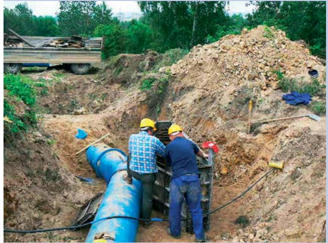
Prace przy realizacji magistrali wodociągowej GPW-zbiornik Chrzanów w pobliżu nowobudowanych zbiorników wody w Chrzanowie.
